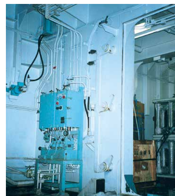
隔壁ドアー用制御盤
