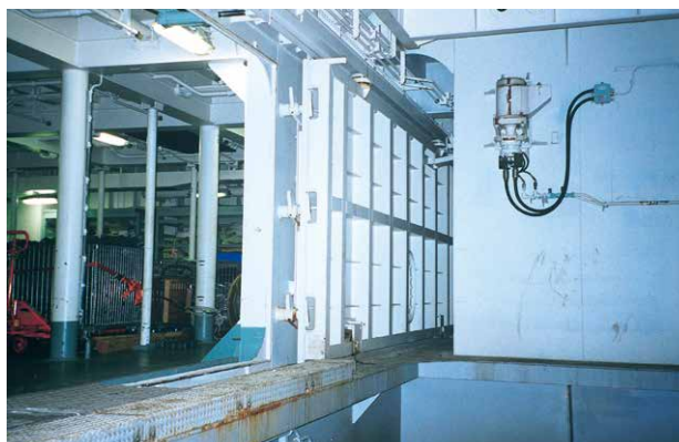
エアークッション艇通行用スライド式隔壁ドアー
