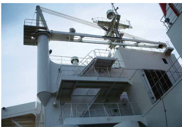
エンジンパーツハンドリングクレーン(4TON×11.5MR) Engine parts handling crane
